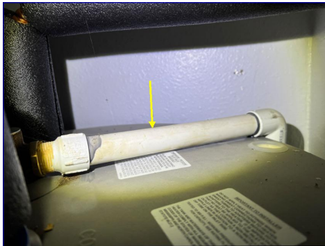
PVC discharge pipe
