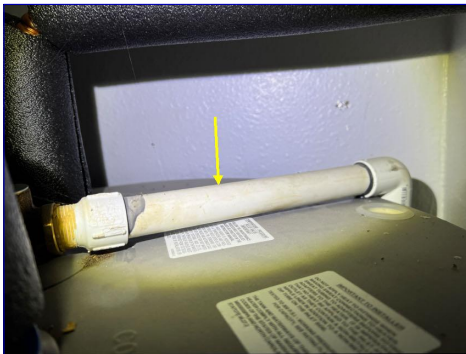
PVC discharge pipe
